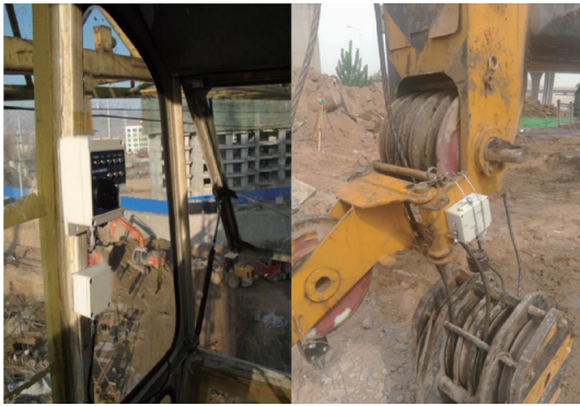
图 18 防外破装置现场报警测试
